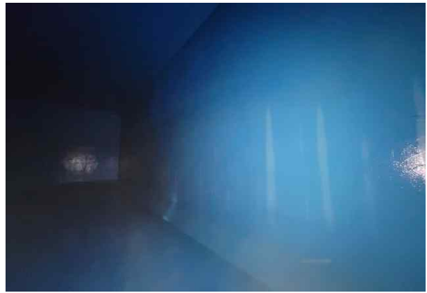
손상내용 2지 벽체 상태양호 손상원인 -
