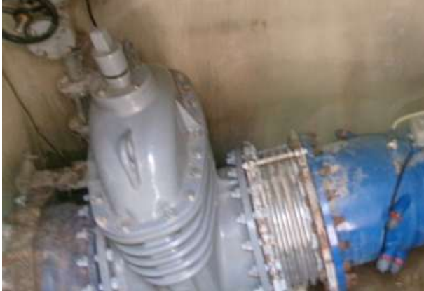
위 치 송수관로 Sta.4+0.0(유량계실) 손상내용 유입신축관 볼트 부식
