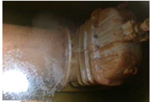
위 치 송수관로 Sta.17+1.5(점검구) 손상내용 볼트 부식
