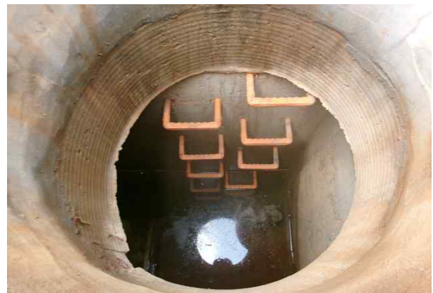
위 치 송수관로 Sta.17+1.5(점검구) 손상내용 침수(H=1.5m)
