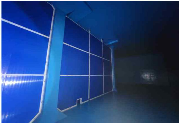
손상내용 2지 기둥 상태양호 손상원인 -
